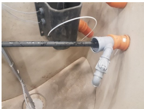
Bild 3 (inside brunn vid pumpning med bräddavlopp) Slanginstick ca 1 m
