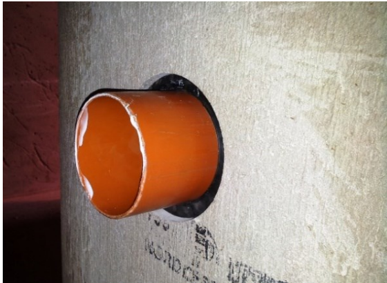
Bild 1 (utsida brunn vid självfall)
