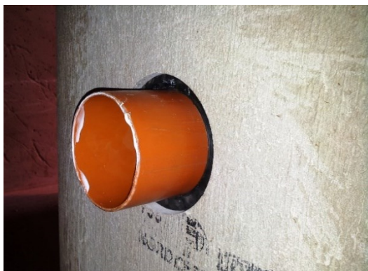
Bild 1 (utsida brunn vid självfall)
