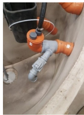
Bild 2 (insida brunn vid självfall)
