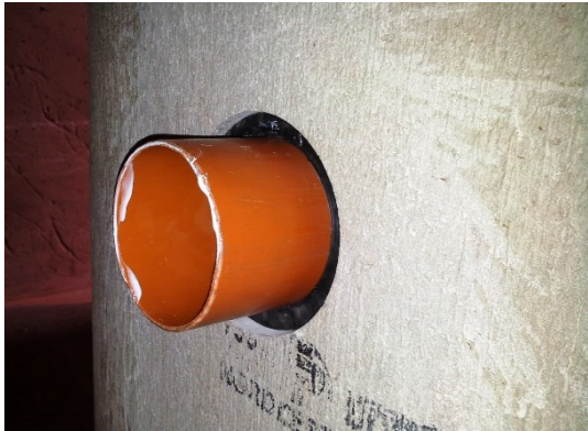
Bild 1 (utsida brunn vid självfall)
