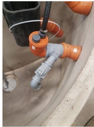
Bild 2 (insida brunn vid självfall)
