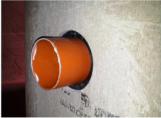
Bild 1 (utsida brunn vid självfall)
